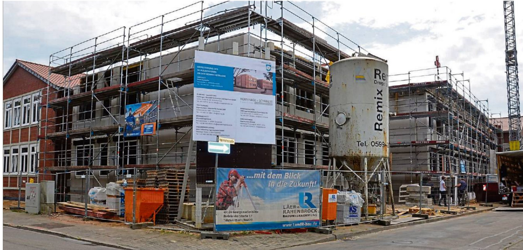
Der Rohbau der Schulerweiterung an den Heinrichstraße steht, jetzt werden die Fensterrahmen eingesetzt.
